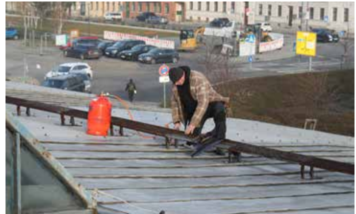
Das Dach musste geflickt werden, vorher wurden in den Dachstuhl neue Balken eingezogen. Seitenwände waren teilweise zu verschließen
