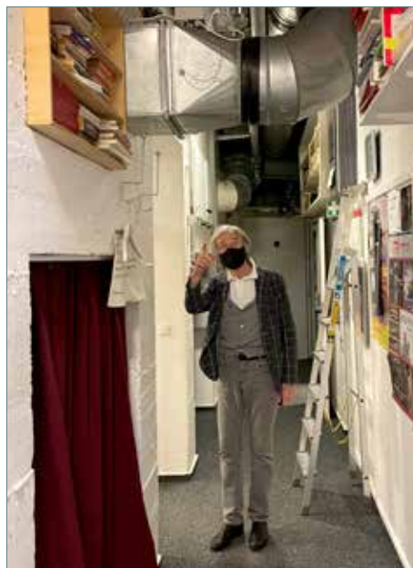
Horst Johanning erläutert die neue Lüftungsanlage mit Ionisierung. Foto: Juliane Schmidt-Sodingen
