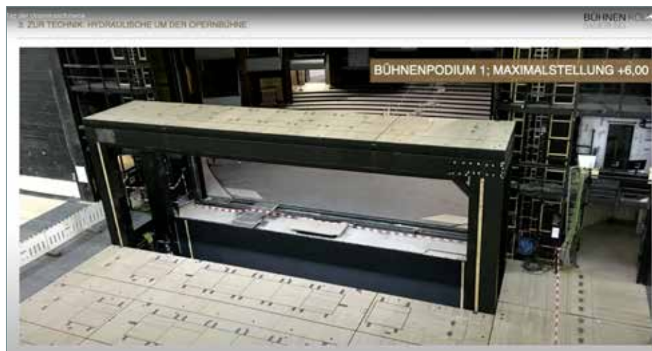
Im Kölner Opernhaus werden die kleineren Podien elektrisch und die großen hydraulisch bewegt. Hier das große Bühnenpodium 1 mit 3 x 16 Metern. Foto: Screenshot (DTHG)
