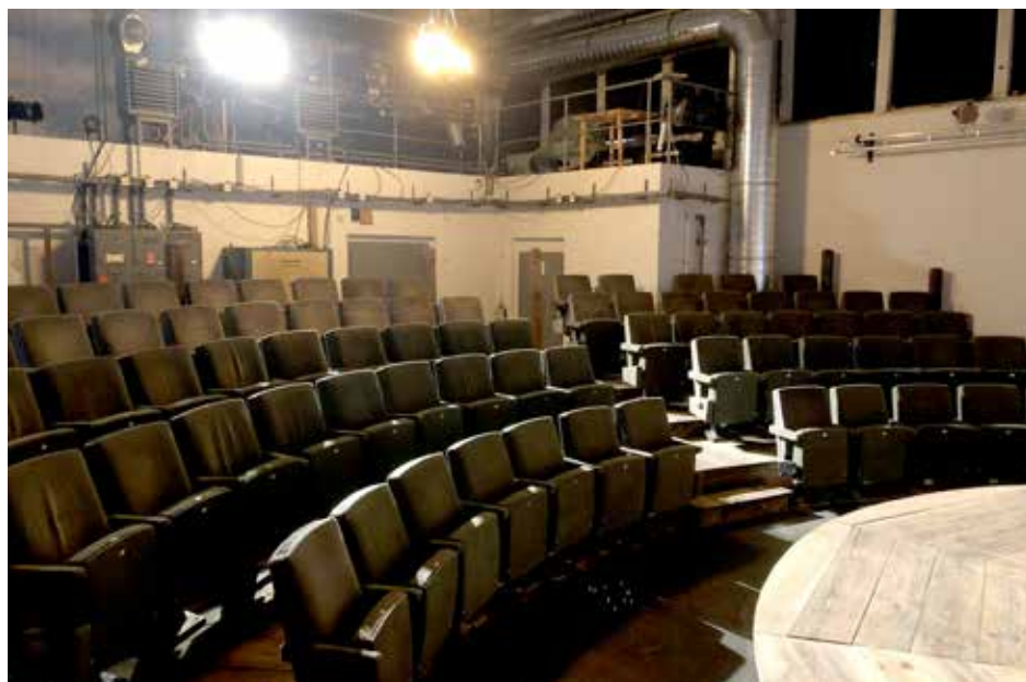
Modern und nachhaltig arbeiten: Zuschauerraum mit Lüftungsanlage und Tribüne als Druckraum, 2021. Foto: Andere Welt Bühne
