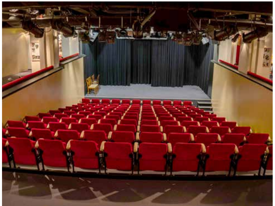
Traditionsreiche Leipziger Pfeffermühle: installierte zwei Umluftgeräte im Zuschauersaal. Foto: Stephan Richter
