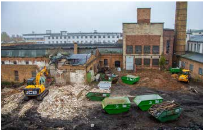
Beräumung des Baufeldes auf dem Gelände der ehemaligen Tuchfabrik in Finsterwalde. Foto: Stadt Finsterwalde
