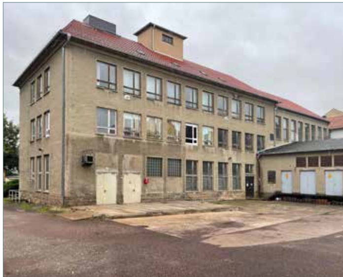
Die Gebäude aus den 1950er-Jahren waren bereits vor der Brandstiftung und dem Umbau in einem schlechten Zustand
