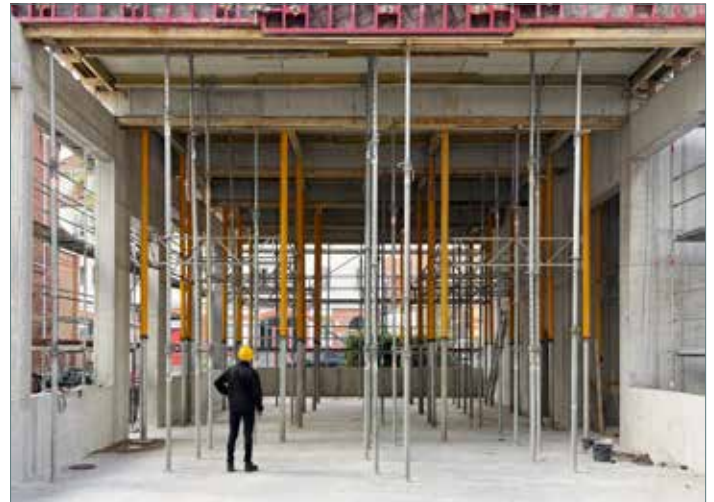
Das Kulissenlager besitzt jetzt die notwendige Raumhöhe von sieben Metern. Die Halle ist stützenfrei und kann an neue Nutzungen angepasst werden
