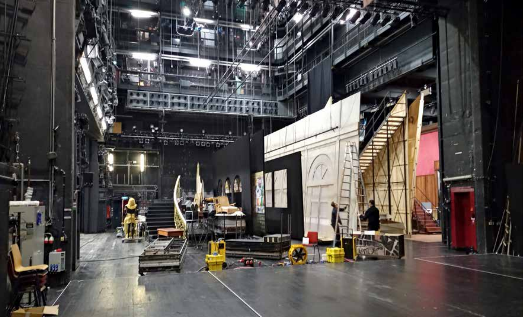
Fehlerhafte Auslösung der Löschanlage im Dezember 2017 im Pfalztheater Kaiserslautern. Foto: Pfalztheater Kaiserslautern
